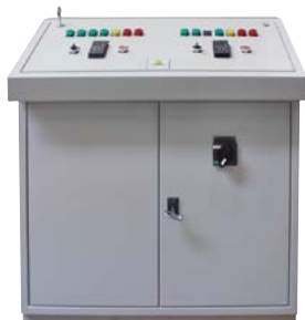
Электрощит в виде пюпитра
